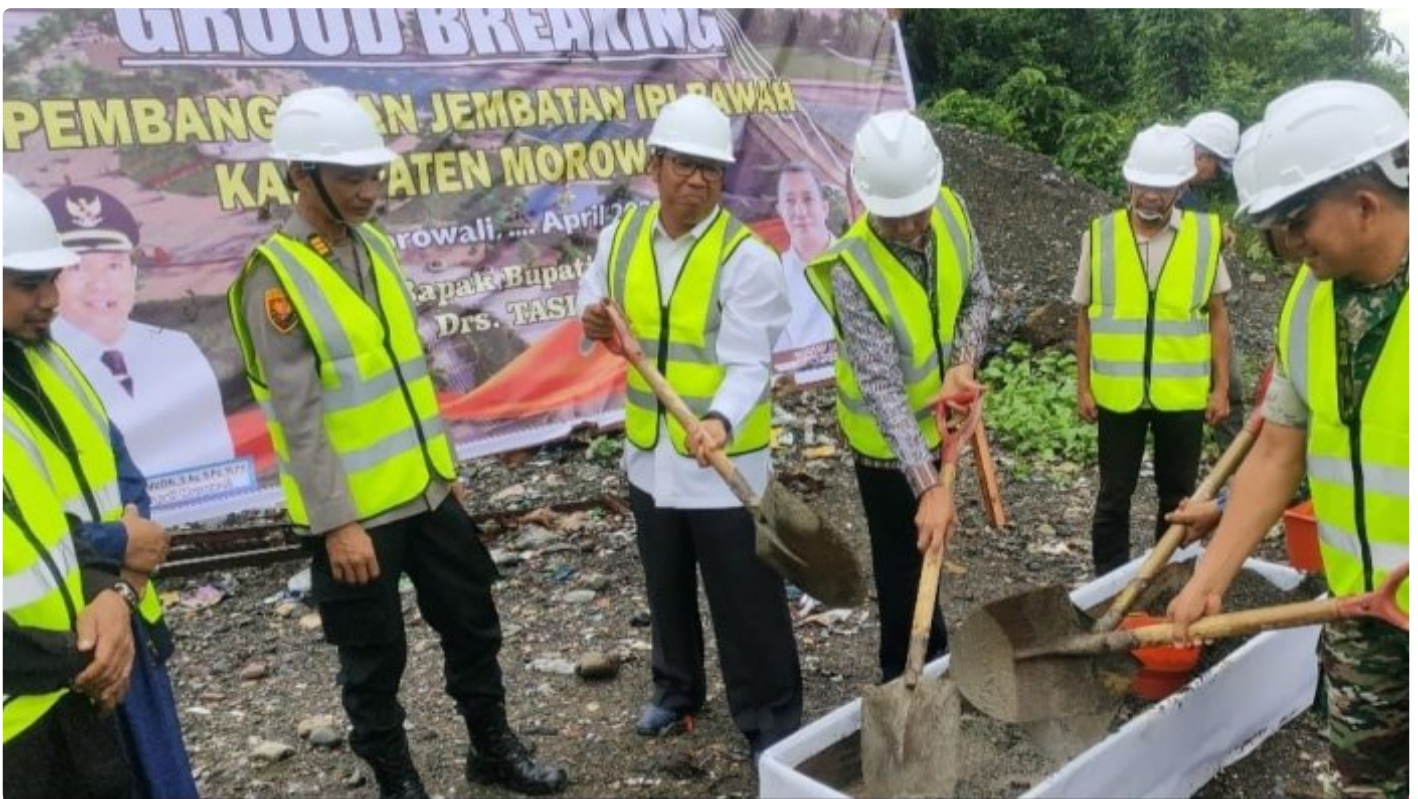
Bupati bersama W. Bupati Morowali didampingi Dandim 1311/Mrw dan undangan lainnya melakukan peletakan batu pertama pembangunan jembatan Ipi bawah
